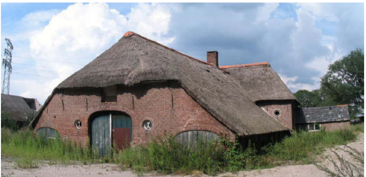
Pothoven in 2021: zwaar verwaarloosd
